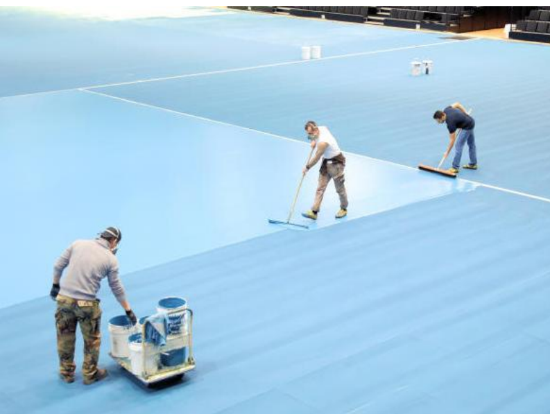
Der Tennisboden in der CGM Arena wird verlegt – am Wochenende liefern die Arbeiten in der Sporthalle auf dem Oberwerth auf Hochtouren, heute können die Koblenz Open beginnen. Foto: Didi Mühlen
